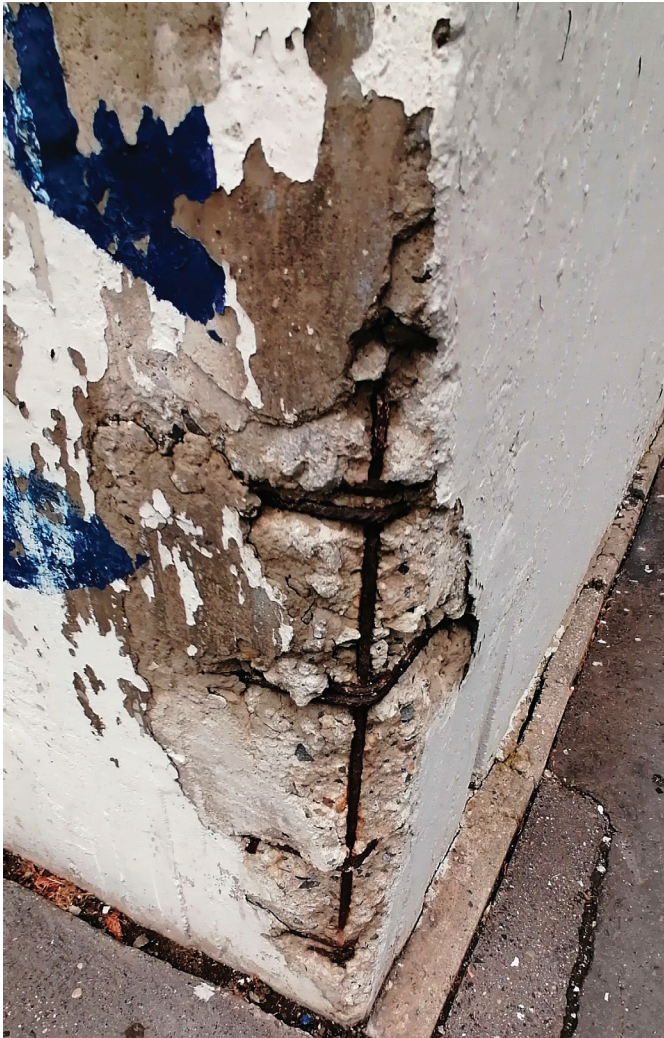
Obr. 4. Degradace výztuže železobetonu.
