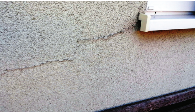
Obr. 1. Nestatická trhlina v omítce, jedná se o technologickou nekázeň, kdy není dodržena technologie aplikace armovací tkaniny.
