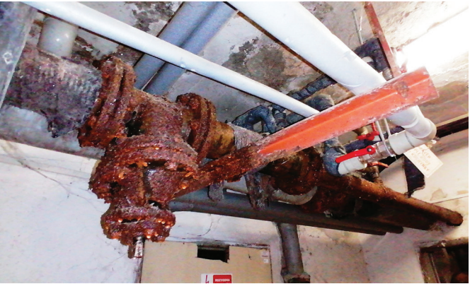
Obr. 5. Ocelová konstrukce napadená nadměrnou korozí ocelových částí hlavních rozvodů vody – velmi vážný havarijní stav.
