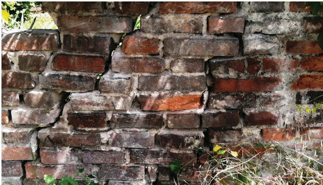
Obr. 2. Havarijní trhlina, která ohrožuje statickou stabilitu nosné konstrukce stavebního objektu.
