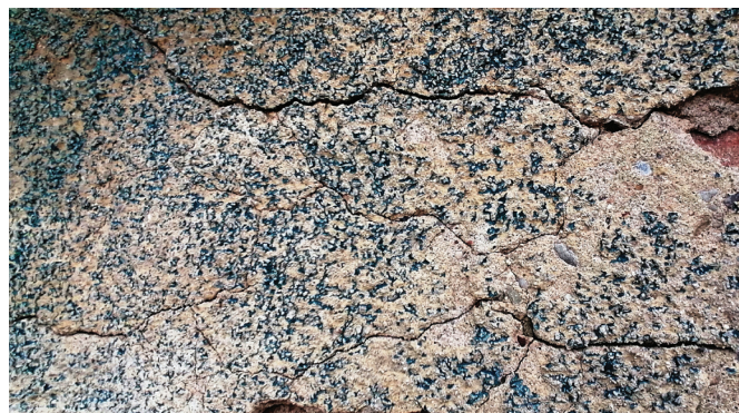
Obr. 3. Trhliny v omítce, špatná technologie omítání – rychlé vysušení a následná degradace omítky.
