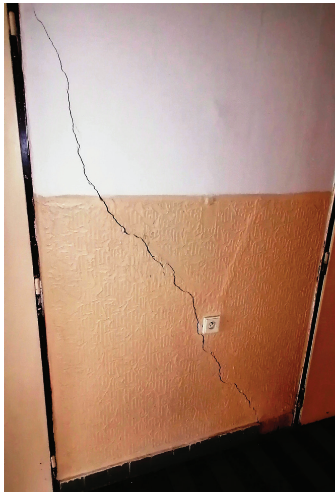
Obr. 6. Trhлина, prasklina mezi dveřními zárubněmi způsobená dlouhodobými dynamickými otřesy.
