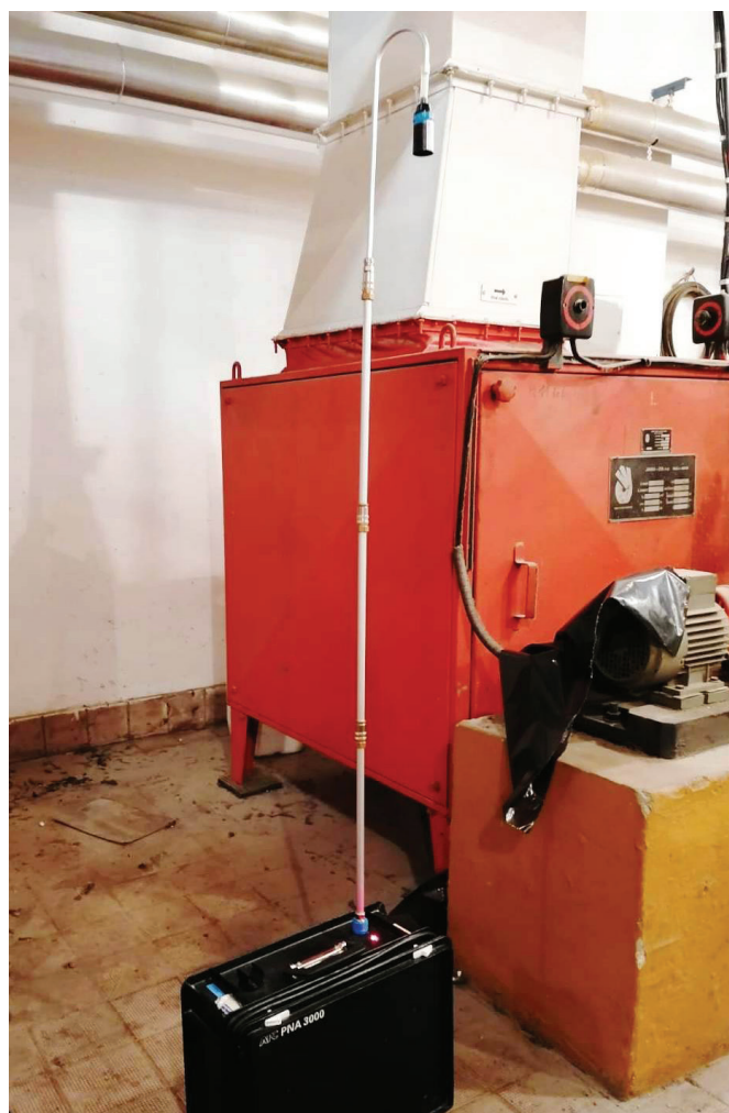
Obr. 1. Ukázka akreditovaného měření koncentrace azbestových vláken unikajících ze stavebních materiálů obsahujících azbestová vlákna.
