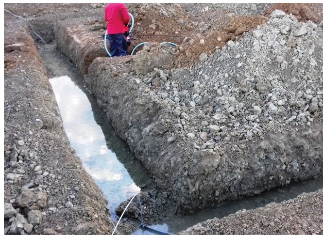
Obr. 1: Pozemní voda se nepříznivě projevuje při zakládání stavebního objektu.
